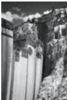
Bau der Staumauer von El Cajon, Honduras, 1979–1985. Projektierung durch die Motor-Columbus Ingenieurunternehmung.
